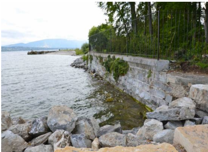
La barrière empêche de passer... du moins à pied sec. RIVES PUBLIQUES
